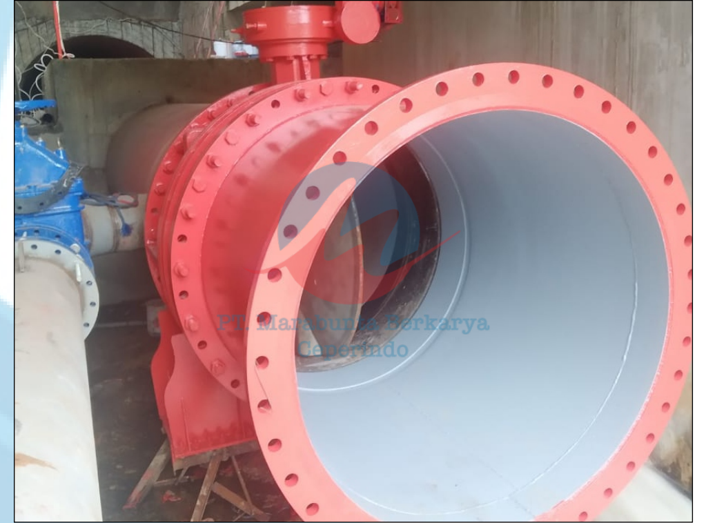
INSTALASI BUTTERFLY VALVE DN1600 BENDUNGAN LADONGI
