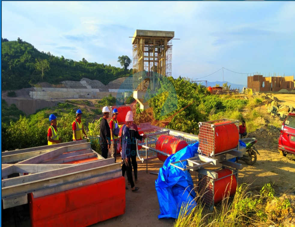
TRASHBOOM BENDUNGAN LADONGI
