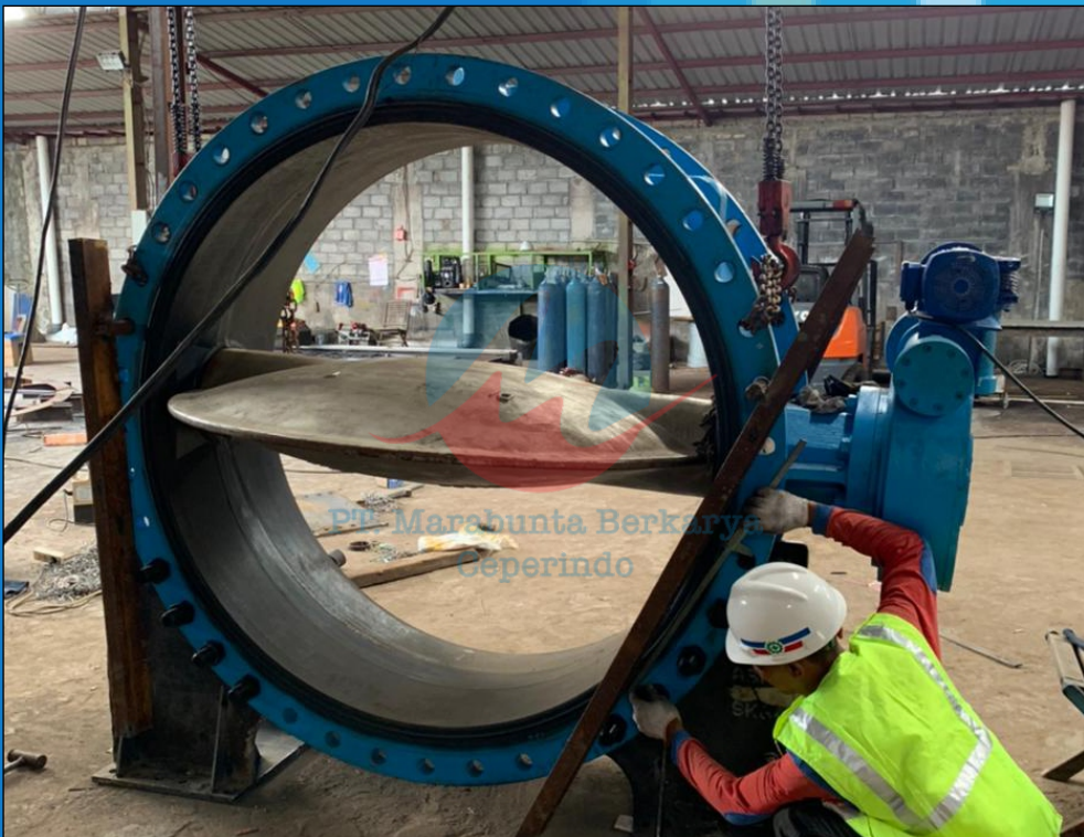
BUTTERFLY VALVE DN1600 BENDUNGAN LADONGI
