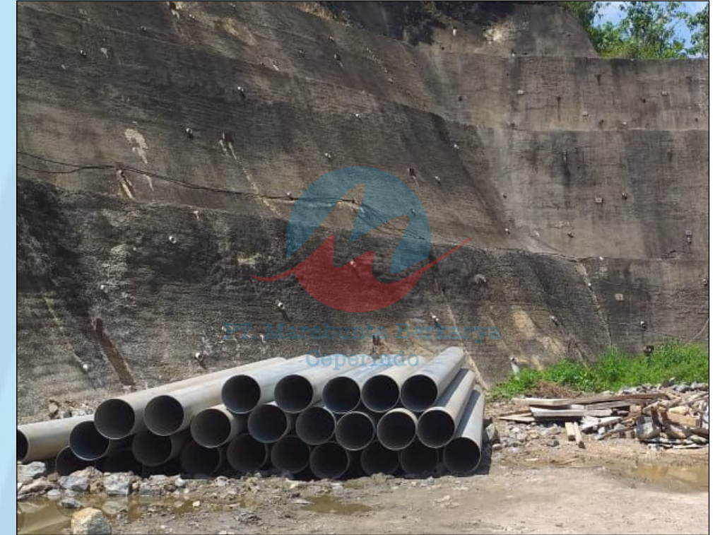
PIPA KEBUTUHAN HIDROMEKANIKAL BENDUNGAN LADONGI
